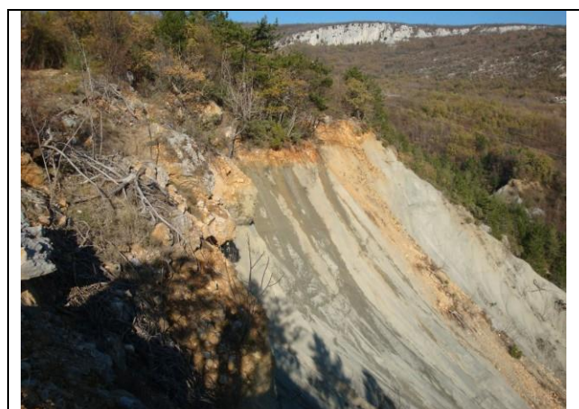
Slika 3.4.1.-7 Područje odrona kod stac. km 1+900,00. Odron naslaga pokrivača ( s_{2,dl} ; Q), debljine 1-5 m. Vidljivo je procjeđivanje površinske vode po kontaktu pokrivača i podloge.
